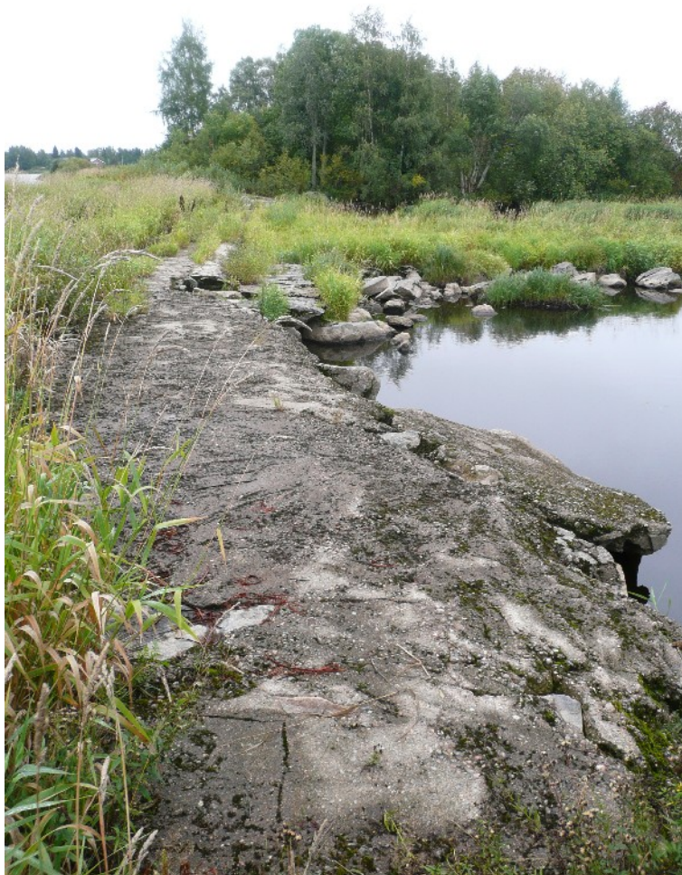
Kuva 18. Betonipatoa kuvattuna pohjoisesta.
